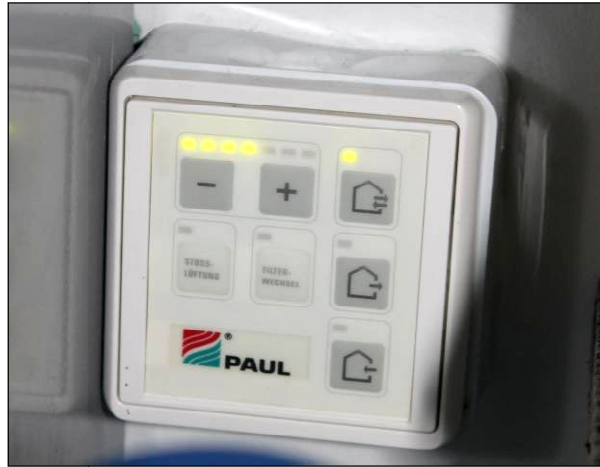
Figura 4: Detalle del mando de control de la ventilación.
