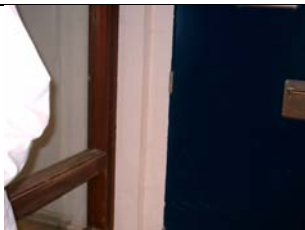
Puerta de salida al exterior con apertura contraria a la evacuación.
